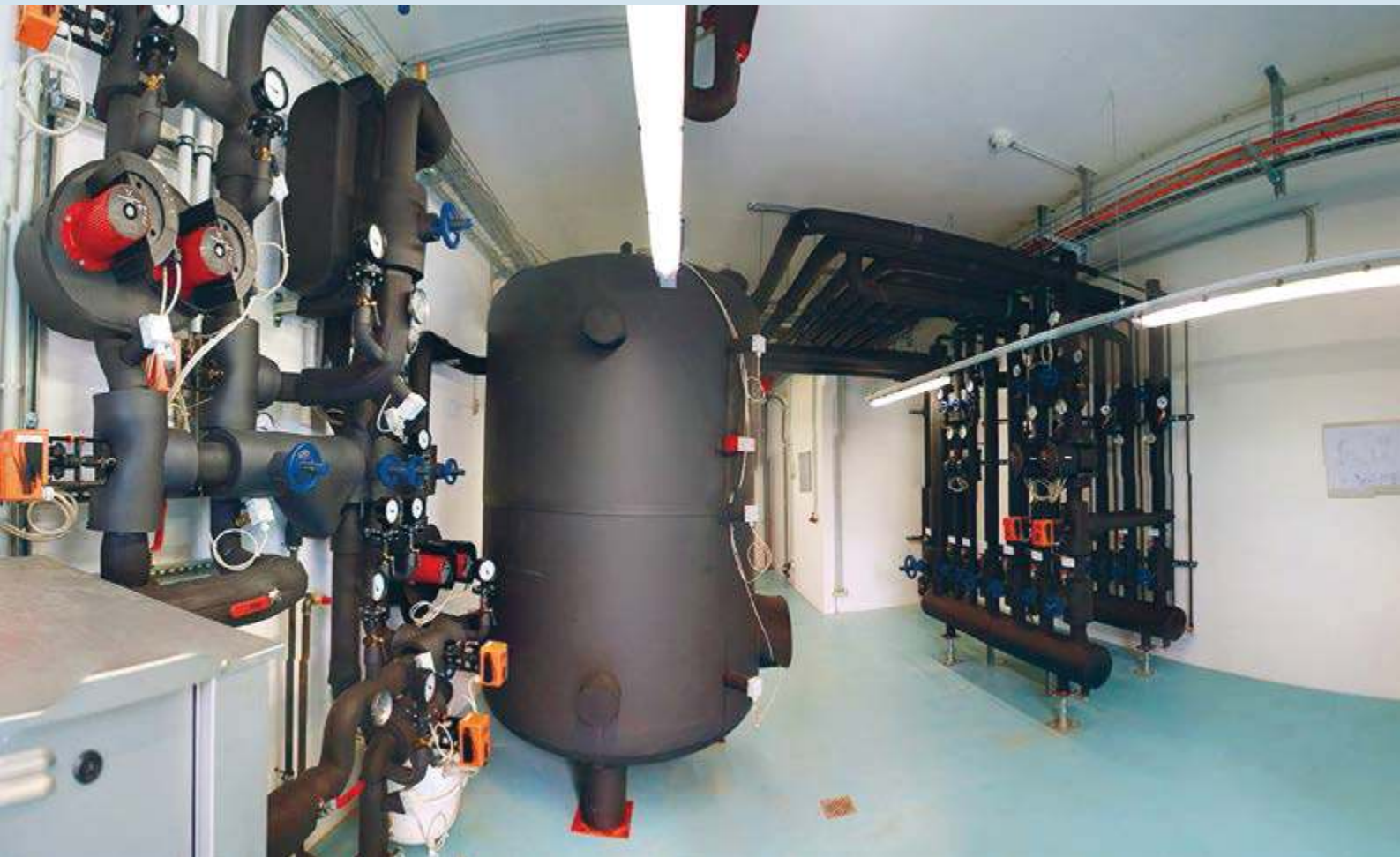
Kühlwasserkreislauf (links Verzweigung Chiller/Wärmetauscher, Mitte Pufferspeicher, rechts Verteilung zu Verbrauchern)
