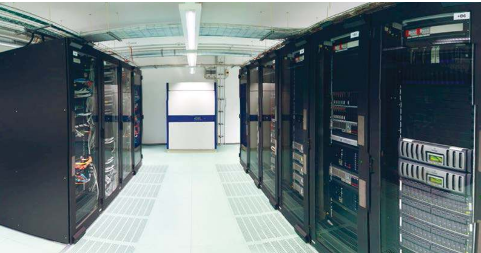
Blick in den Serverraum
